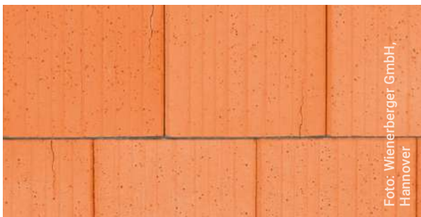
Bild 10: Ziegelmauerwerk mit Trocknungs- oder Brennrissen
